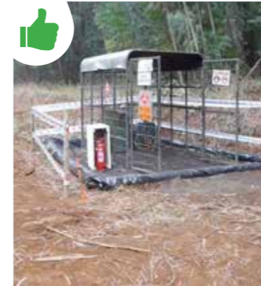
Almacenaje de combustible en terreno.
